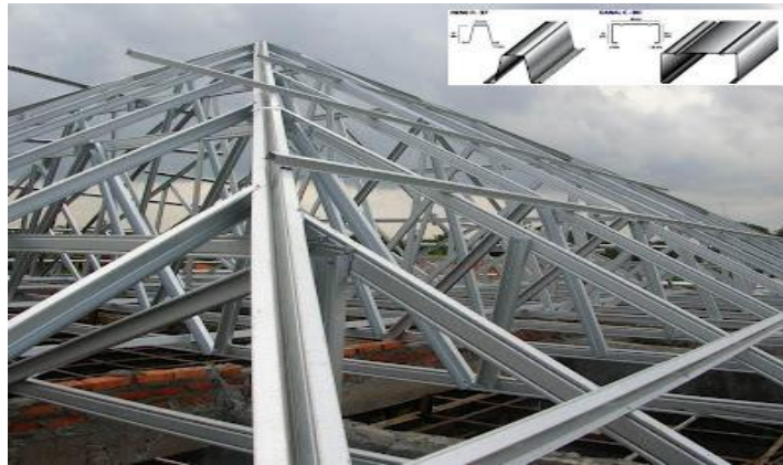
Gambar 1. Rangka Atap Baja Ringan Sumber : Dokumentasi Pribadi
