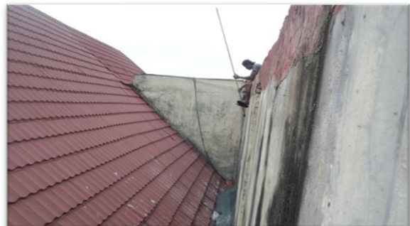
Gambar 4. Kondisi Eksisting Kerusakan Dinding Akibat Kebocoran (Sumber: Citra Drone oleh penulis)
