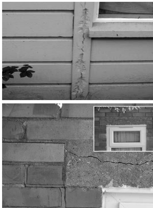
Dua contoh karbonasi Pada Rumah Cornish , satu di palang beton dan satu di kolom bantalan beban.
